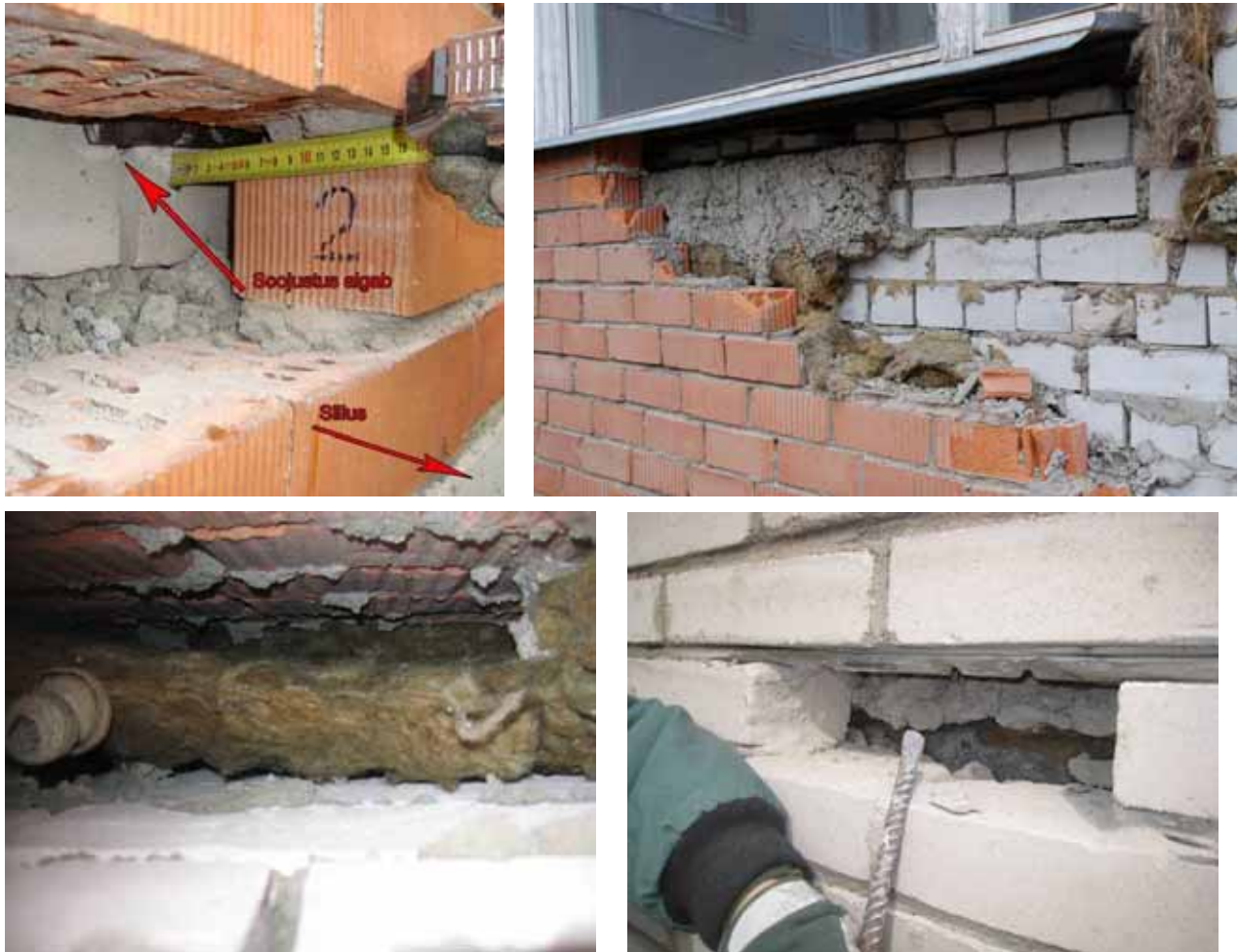
Joonis 2.20 Telliselamu välisseina puudulik soojustus.
